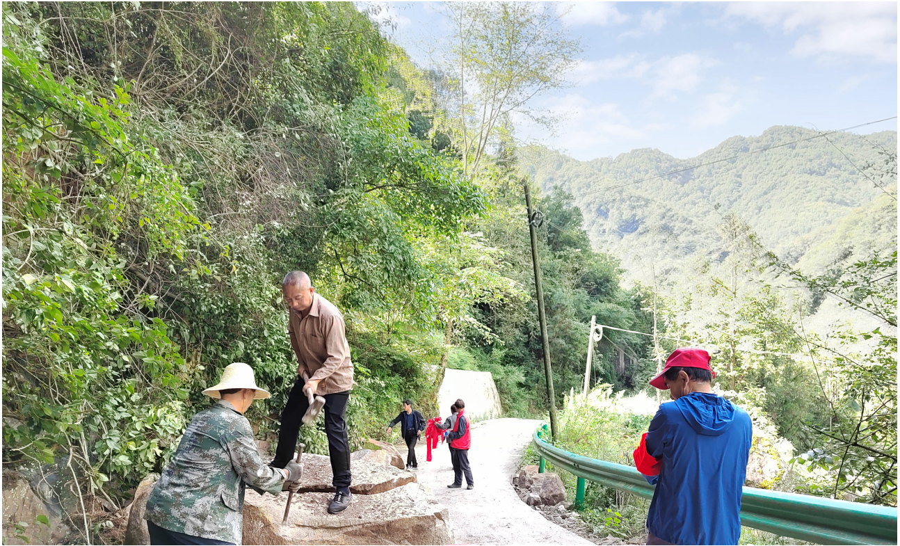
该县在雨后组织清理塌方巨石
